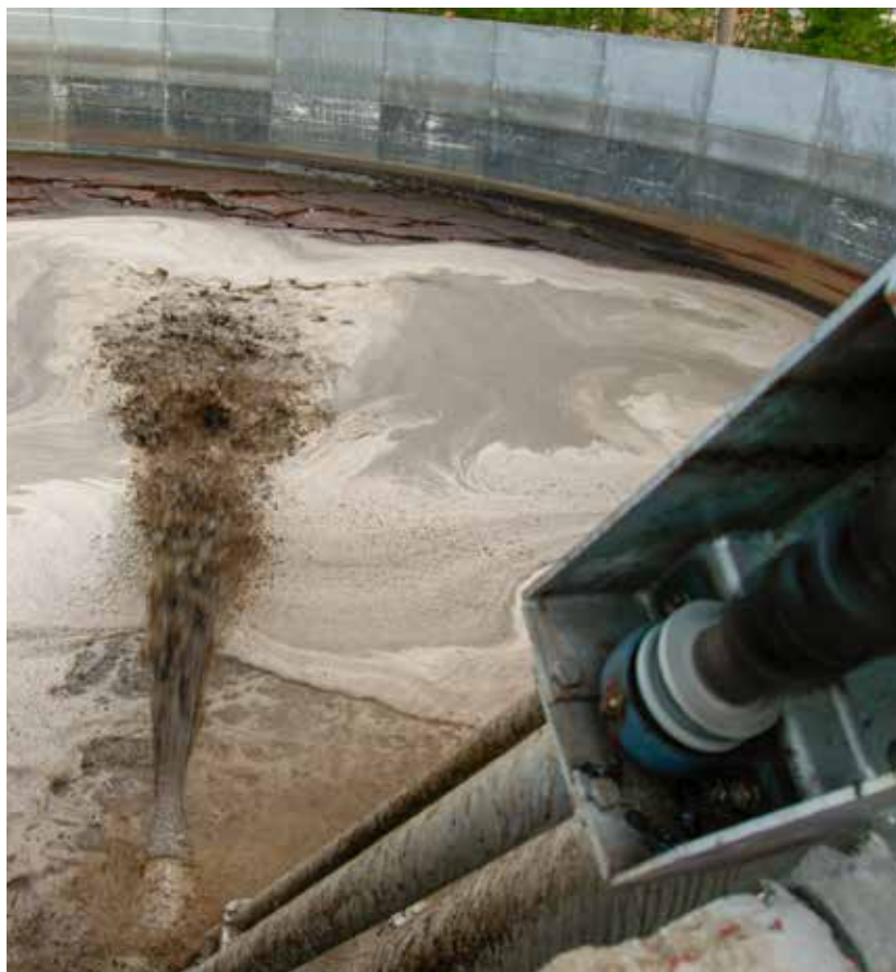
Gass: Ved levering av husdyrgjødsel til biogassanlegg innebærer det å måtte røre husdyrgjødsel også på vinteren, med de risikoer det innebærer. / FOTO: Morten Livenengen
