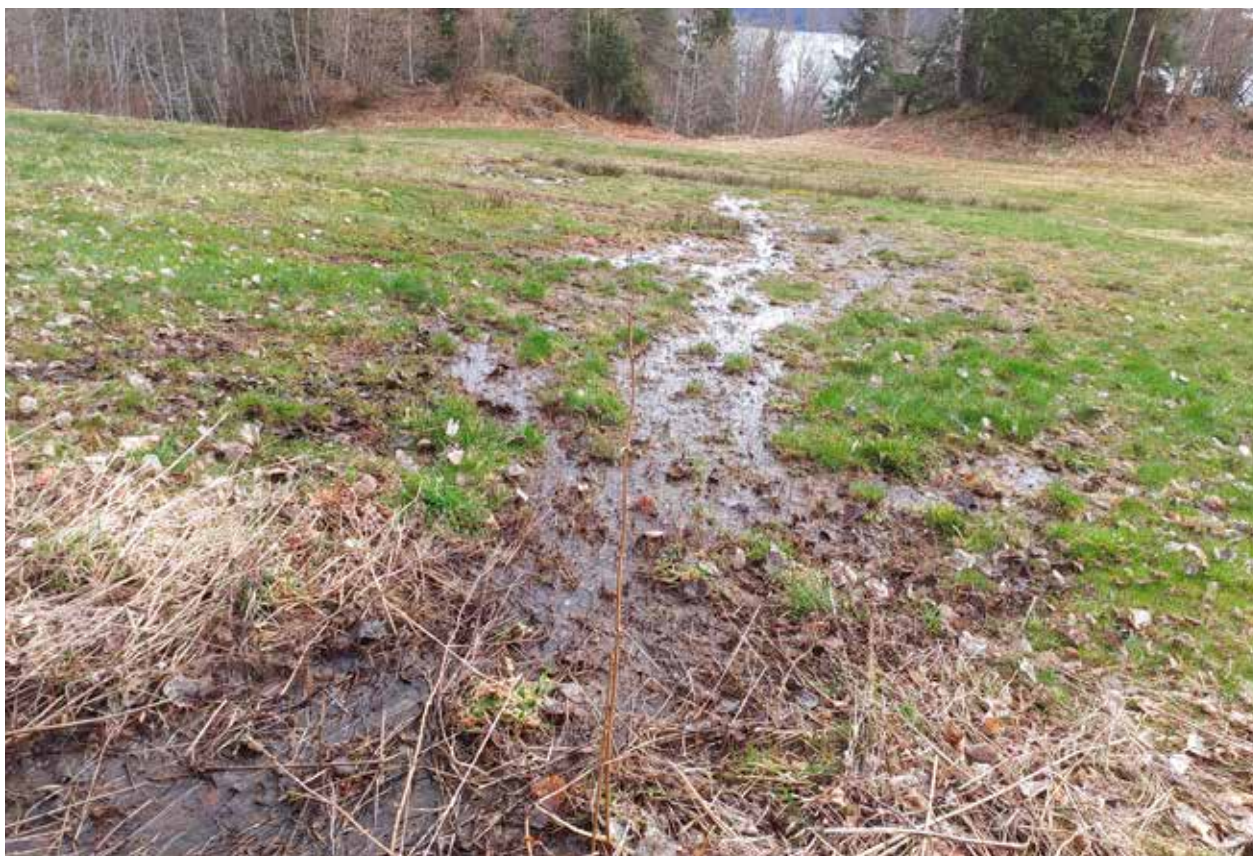
Mangler: Her mangler avskjæringsgrøft i overkant av den dyrka marka, og overflatevann fra områder overfor jordet får fritt renne inn. / FOTO: Atle Horn
