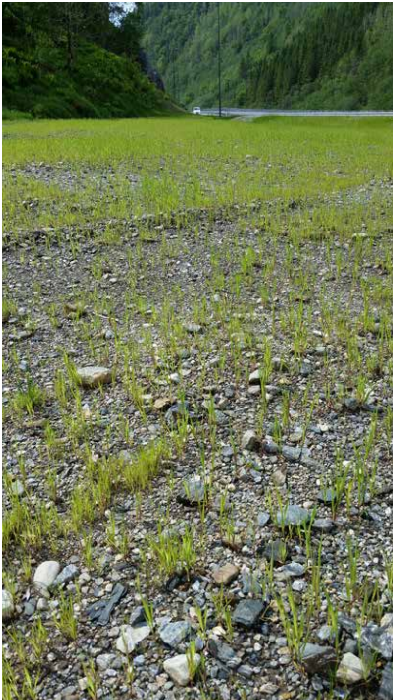
Eksempel på toppdekke som ikke er akseptabelt
